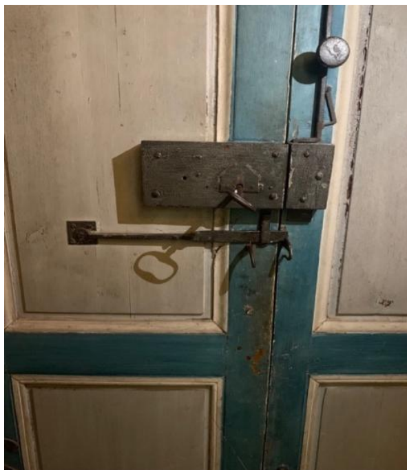
Denna gamla slottsport har både en låsklinka, kammarlås med nyckel och en vertikal skjutregel som kan spärra den andra dörrhalvan.
